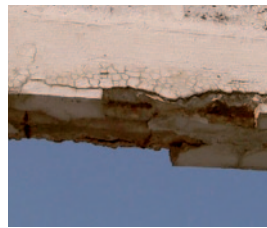
La principale causa del degrado del calcestruzzo è la sua carbonatazione.
